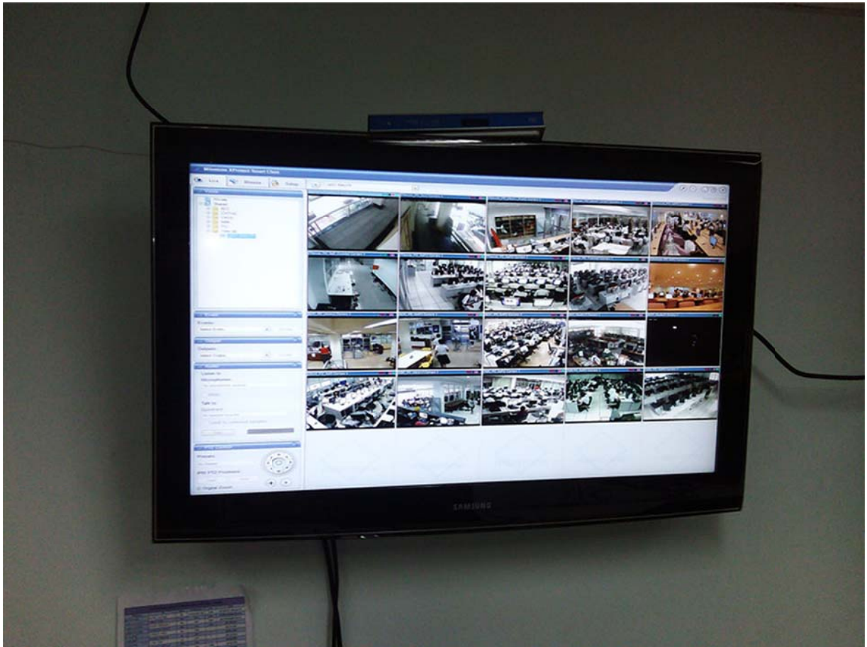
ระบบมอนิเตอร์กล้องวงจรปิดที่ส่วนกลาง ( หมายเหตุ : ส่วนกลางติดตั้ง ณ ศูนย์เทเวศร์ )
