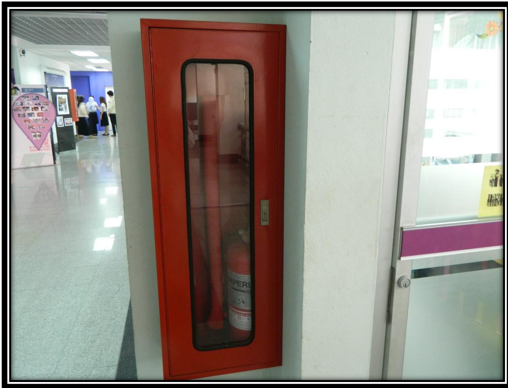
สวท.7.7-1-4 รูปถ่ายถังดับเพลิง
