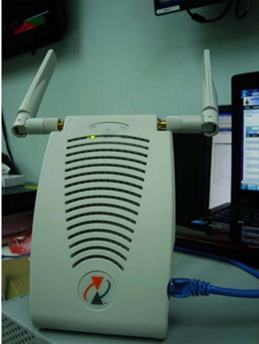
අධ්‍යයනීය Wireless Access Point
